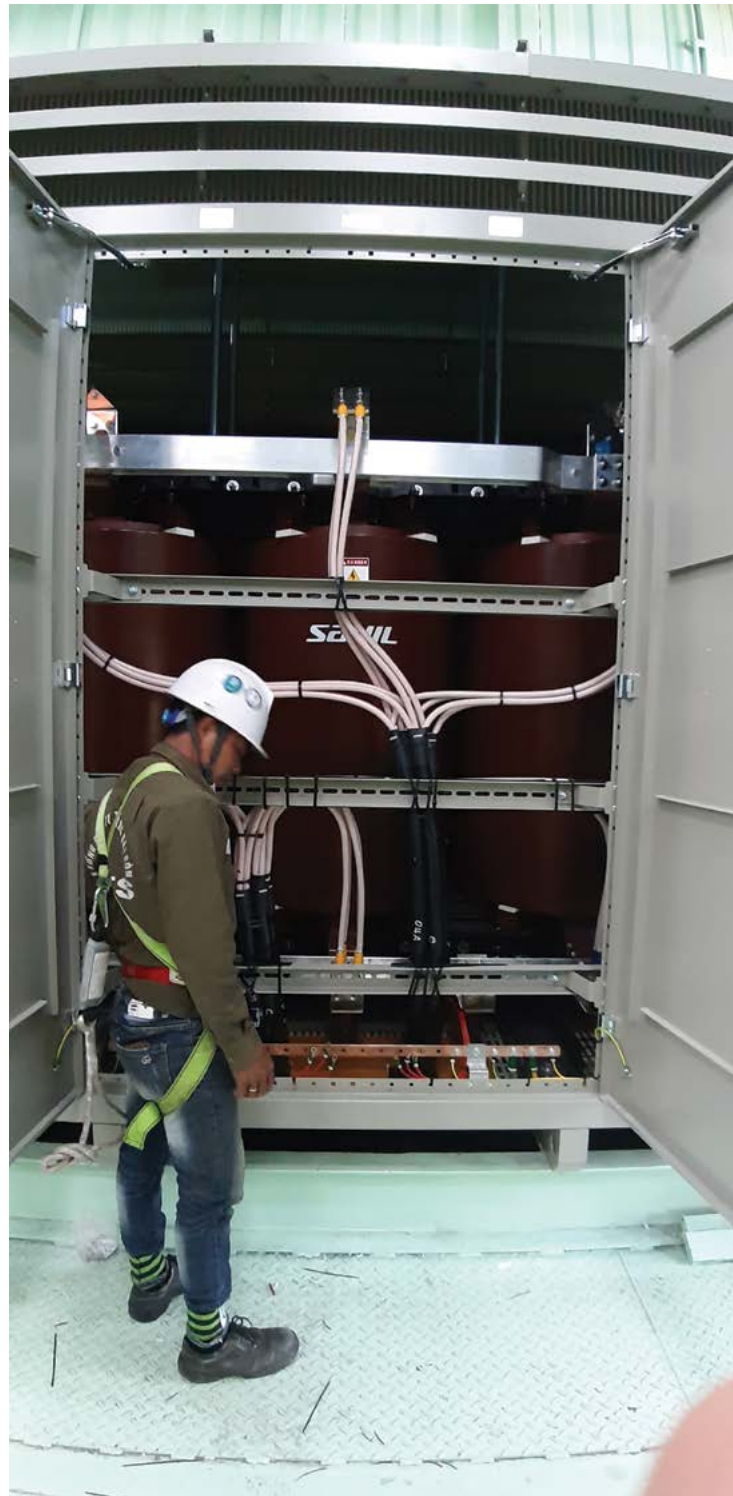
Thi công công trình điện tại Nhơn Trạch Installation Electrical service in Nhon Trach
