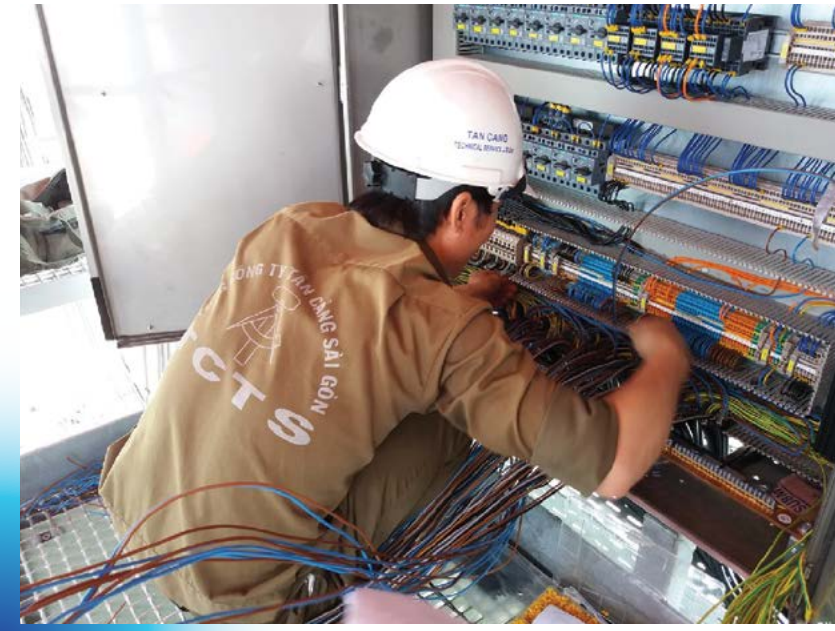
Hoàn cải hệ thống điện điều khiển trên Cầu KE01 Cảng Cát Lái Converting the electrical control system KE01 Crane in Cat Lai port
